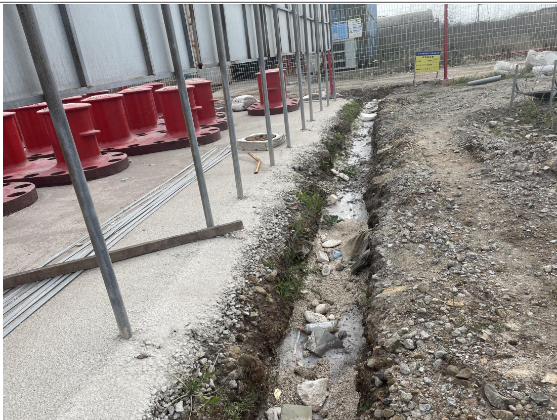
现状：1#施工生产区临时排水沟有淤积。 建议：建议及时清淤，保证排水顺畅。
