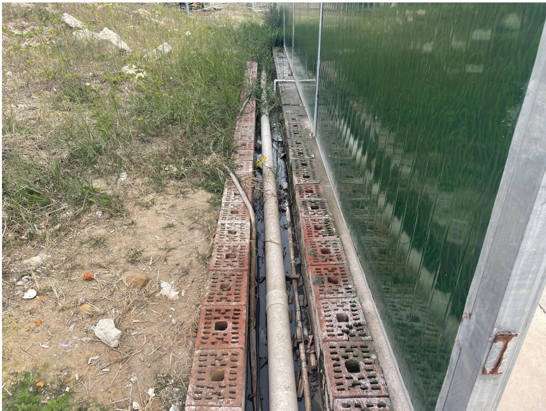
现状：施工生活区临时排水沟有淤积现象。 建议：建议及时清淤，保证排水顺畅。
